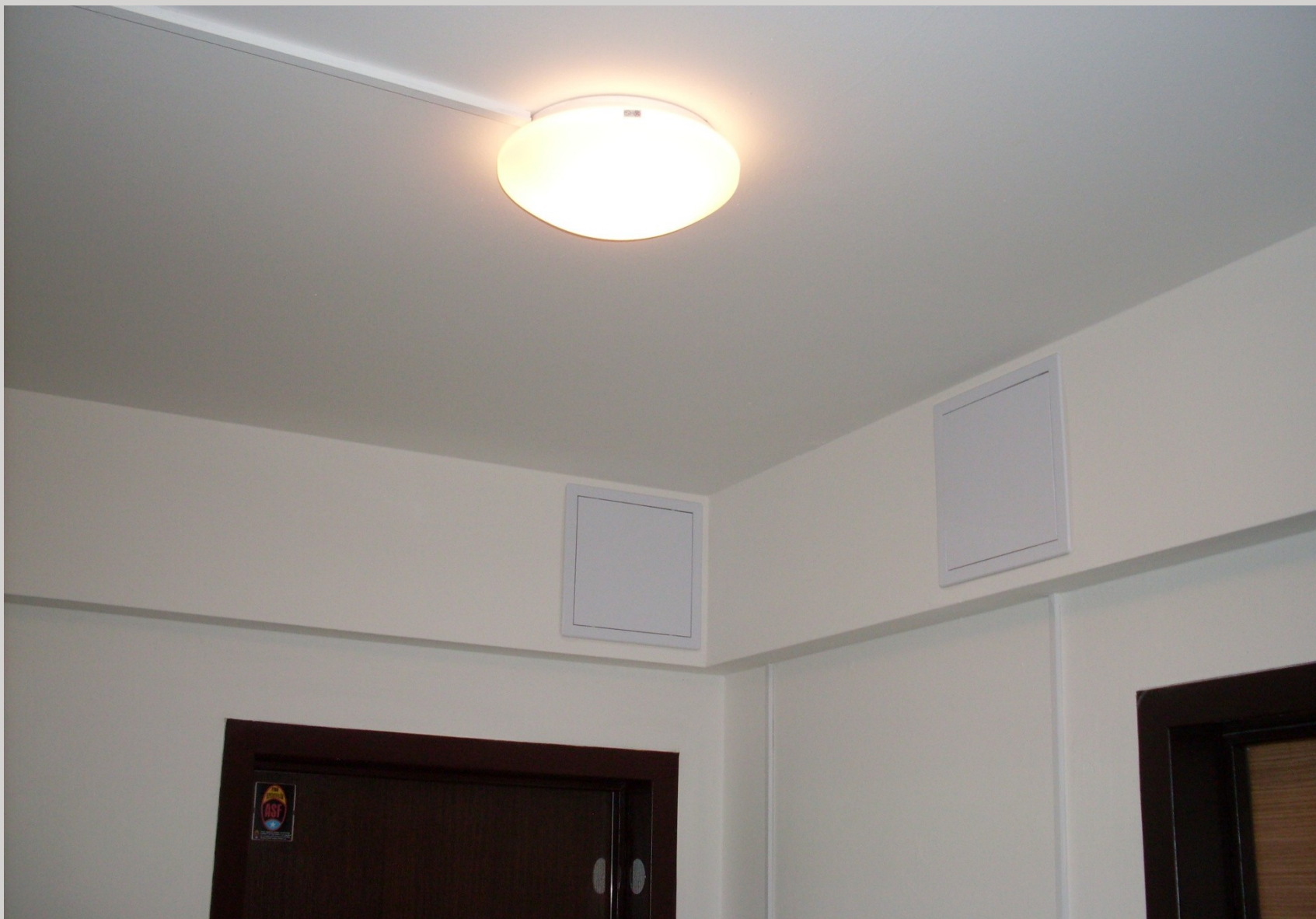
Interiér domu – komplet nové osvětlení s pohybovými čidly
